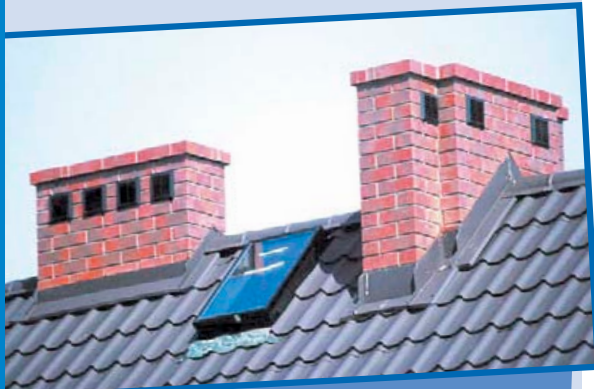
Wentylacja wyprowadzona na dach powinna być zabezpieczona kratką
